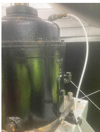
Odpowietrznik na przekładni
