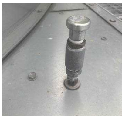
Odpowietrznik na płycie wentylatora
