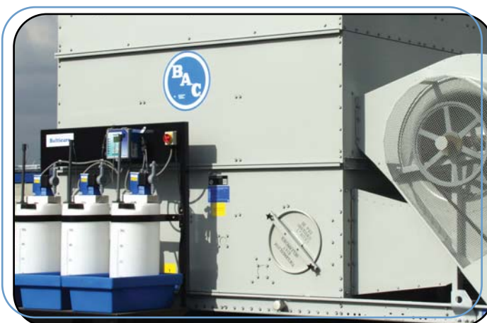
Photo 3. Poste de traitement d'eau typique BAC - Balticare
