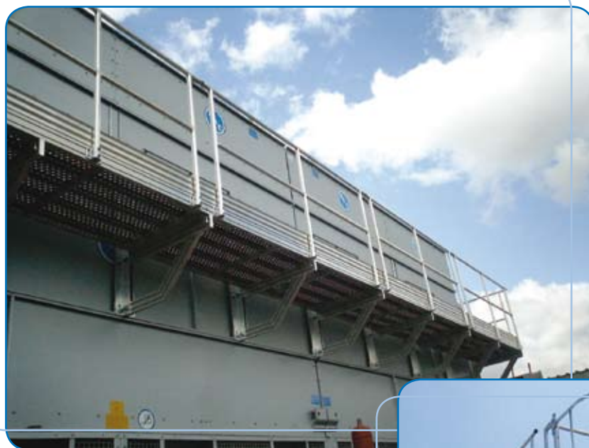
BAC-toestel VXI-koeltoren met gesloten kringloop voorzien van een uitblaasgeluiddemper
