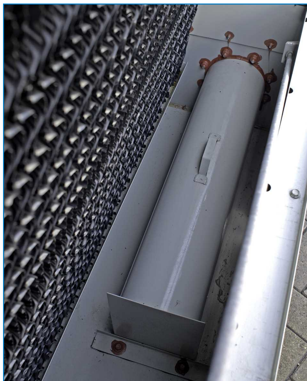
Nádrž na ochlazenou vodu a filtry nádrže
