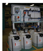
Zařízení pro úpravu vody
