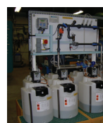
Oprema za tretman vode
