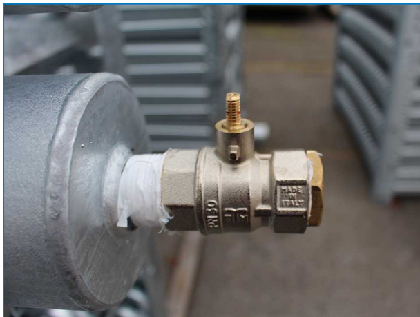
Oberer Rohrbündelanschluss mit Überdruckventil auf Verdunstungsverflüssigern.
