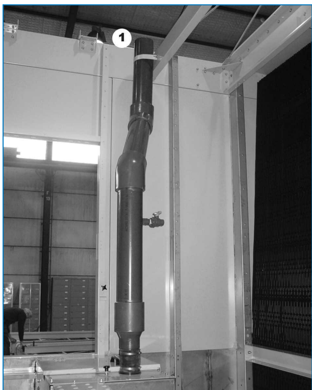
Szivattyúcsövek alsó szakasza
