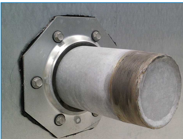
Lägre blockerad slingkoppling (på sluten krets kyltorn med anslutningar upp till ND 100).
