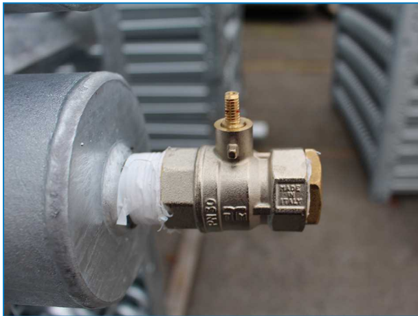
Gornji priključak izmenjivača sa ventilom za otpuštanje pritiska na zatvorenim rashladnim kulama sa priključcima većim od ND100.
