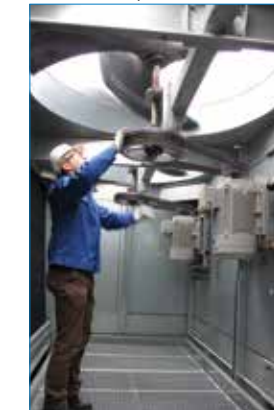
Ventilatoraanrijfsysteem makkelijk rechtstaand toegankelijk
