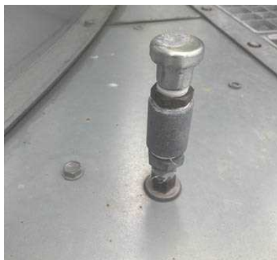
Odvzdušňovač na kryte ventilátora
